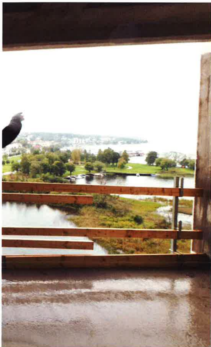
Emilsson från Hökerum bygg ligger de bra till enligt tidsplanen. "Det går jättebra. Stommontörerna
